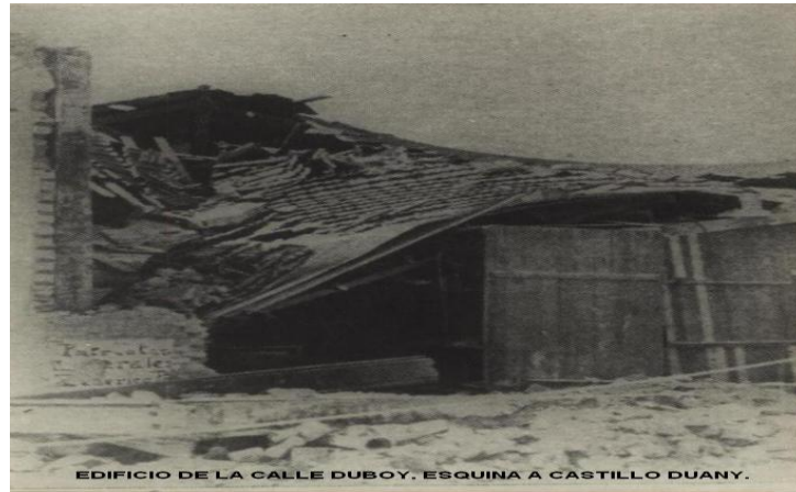
Anexo 2.1. Daños producidos por el terremoto de 1932 en el edificio de la calle Duboy y Castillo Duany. Foto Archivo CENAIS.
